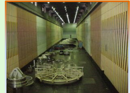
Guri: sala máquinas
